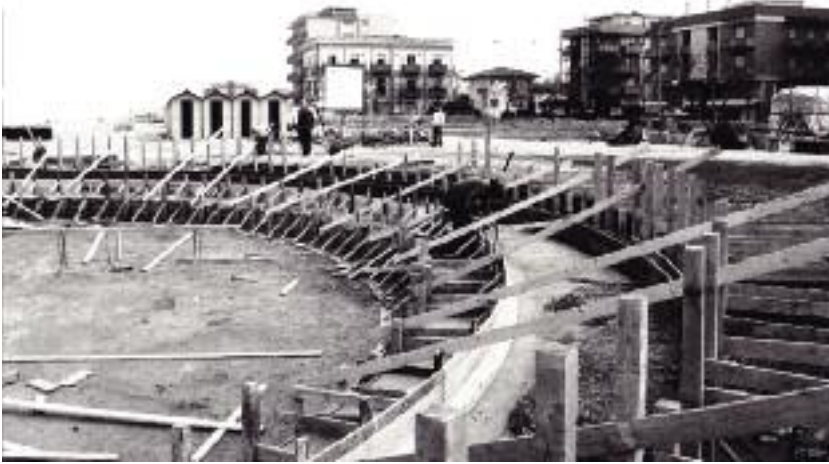
Fig. 40 - Costruzione Anfiteatro Rastatt, inizio anni 80 (Biblioteca Federiciana, Fondo Fotografico, Album 2 "Eventi, Lavori pubblici").
