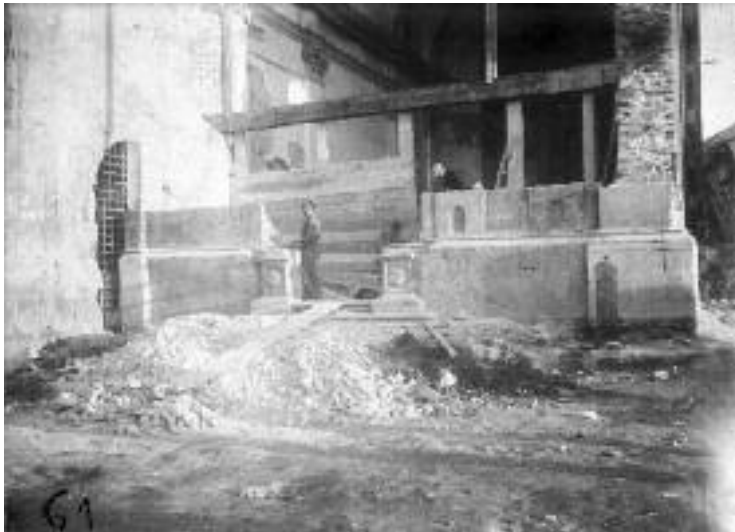
Fig. 27 - Alberto Eusebi. La facciata di San Michele a smontaggio quasi ultimato durante i lavori di arretramento nel 1936 (Biblioteca Federiciana, Fondo Fotografico, Armadio E, scatola 30c f).
