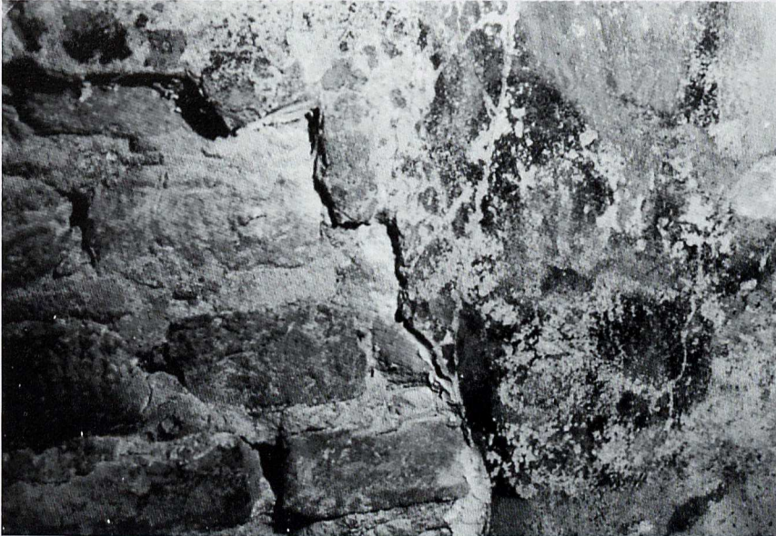
Spanciamento dell'intonaco. È assai evidente il distacco dalla parete. (lunetta n. 6)
